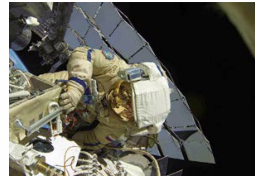
Пётр Дубров переносит бокс с инструментами в зону прокладки кабелей. Фото Олега Новицкого
